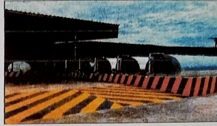
ถังเก็บน้ำมันเชื้อเพลิงบนดิน
