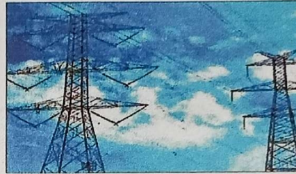
เสาไฟฟ้า
